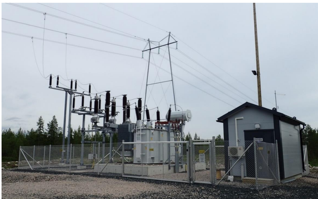
Kuva 9.7. Esimerkki tuulivoimahankkeen sähköasemasta (Minna Takalo, FCG).
