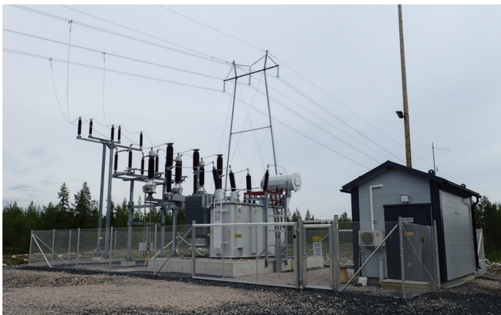
Kuva 9-7. Esimerkki tuulivoimahankkeen sähköasemasta (Minna Takalo, FCG).
